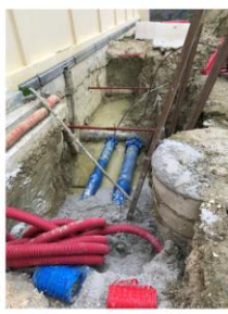
Conduites – départ Bâtiment
