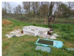
Poste de relevage
